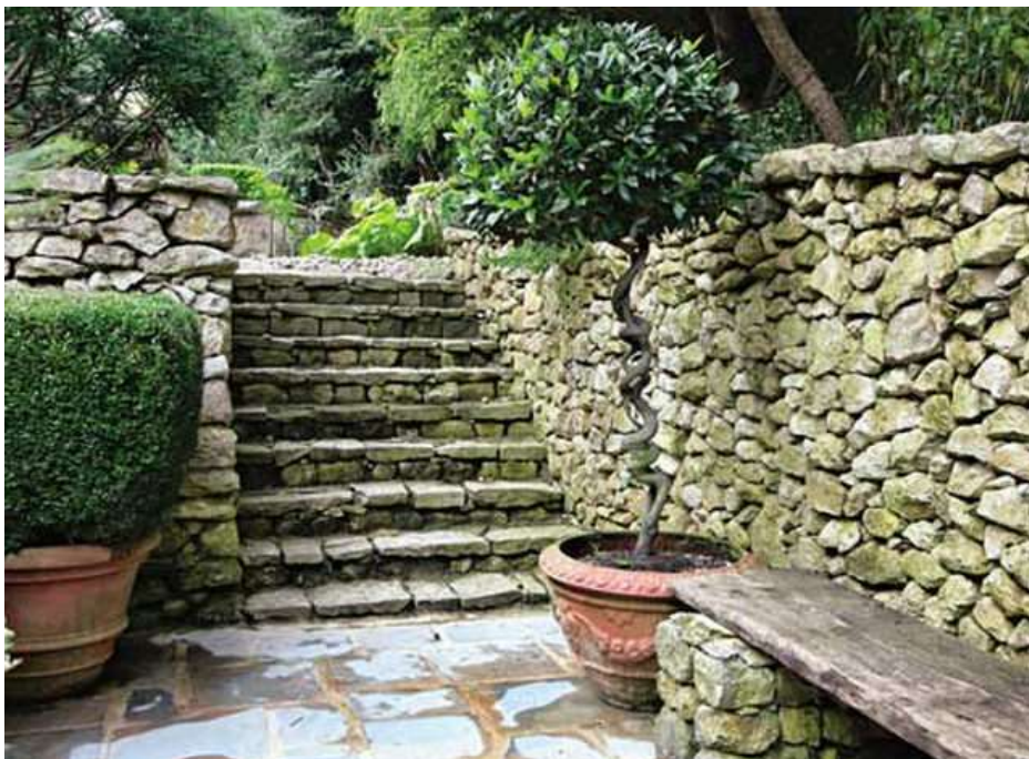
Пример укрепительной подпорной стенки
